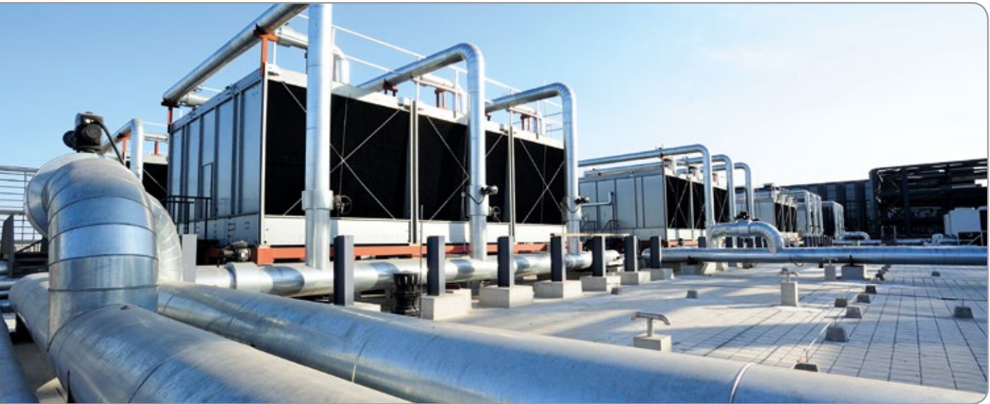
Industrielle Kälte-Klima-Anlage mit Kondensator
